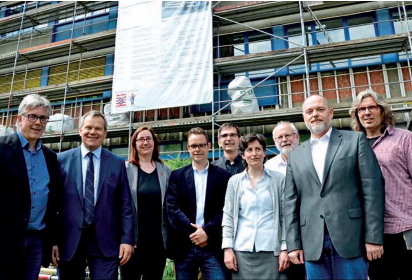
Kick-off für das städtische BildungsBauProgramm: An der Adolf-Reichwein-Schule hat die Fassadensanierung wie geplant begonnen – hier Oberbürgermeister Dr. Thomas Spies (2. v. l.) und Schuldezernentin Dr. Kerstin Weinbach (3. v. l.) mit Vertretern der Schulen sowie der Verwaltung beim Ortstermin.
