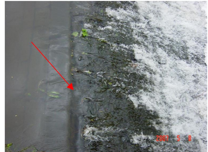
Bild 2: Deutliche Auswaschungen der Deckwerksfugen auf der Wehrkrone
