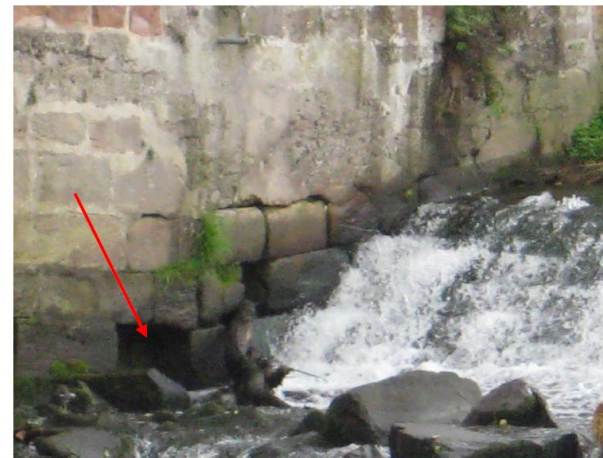
Bild 14: Beschädigtes Mauerwerk am Wehrfuß des rechten Lahnufers
