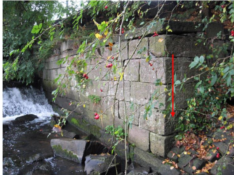
Bild 10: Setzungen im Eckbereich der Stützmauer am linken Lahnufer
