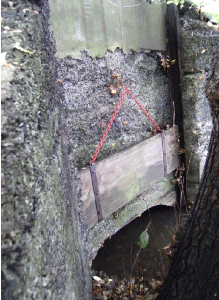
Bild 12: Schützenanlage am Einlaufbauwerk Hirsemühle
