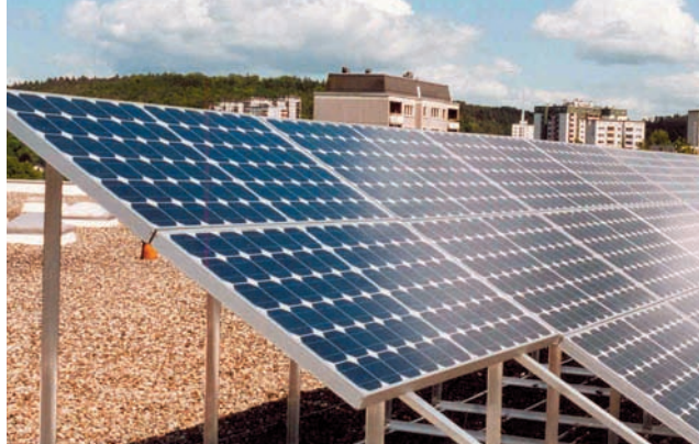
Sonnige Zeiten: Photovoltaik- und Solaranlagen wie hier auf dem Dach der Richtsberg-Gesamtschule sollen in Marburg den Anteil an regenerativen Energien kontinuierlich steigern.
