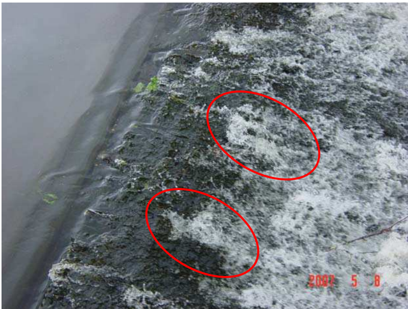
Bild 3: Ungleichmäßige Wasserablösungen auf der Wehrkrone
