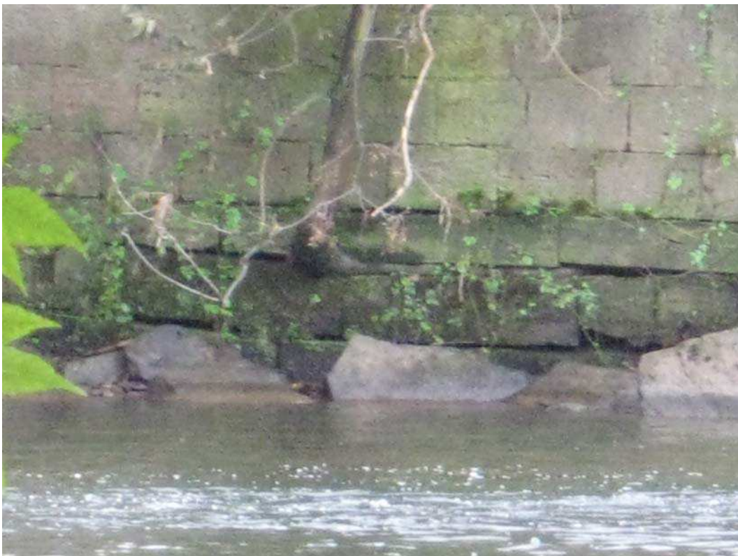
Abbildung 34: Wasserlinie Stützmauer rechts im Unterwasser
