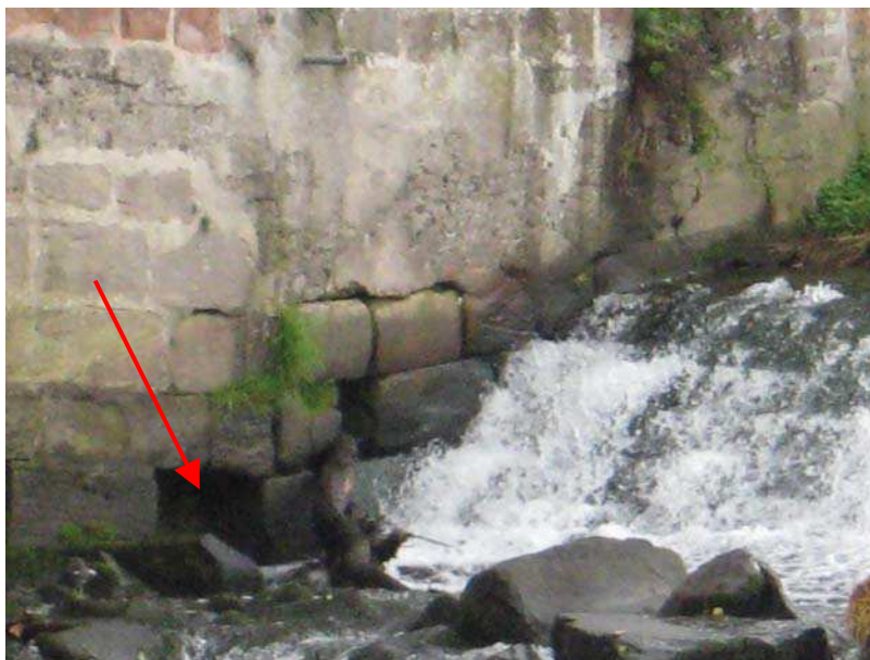
Bild 14: Beschädigtes Mauerwerk am Wehrfuß des rechten Lahnufers
