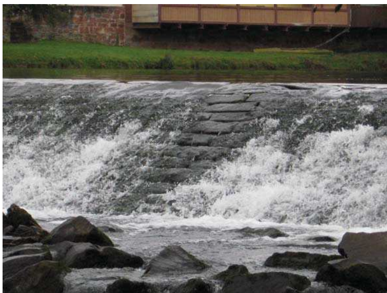
Bild 5: Hochpunkt in der Wehrkrone führt zu Strömungsabriss
