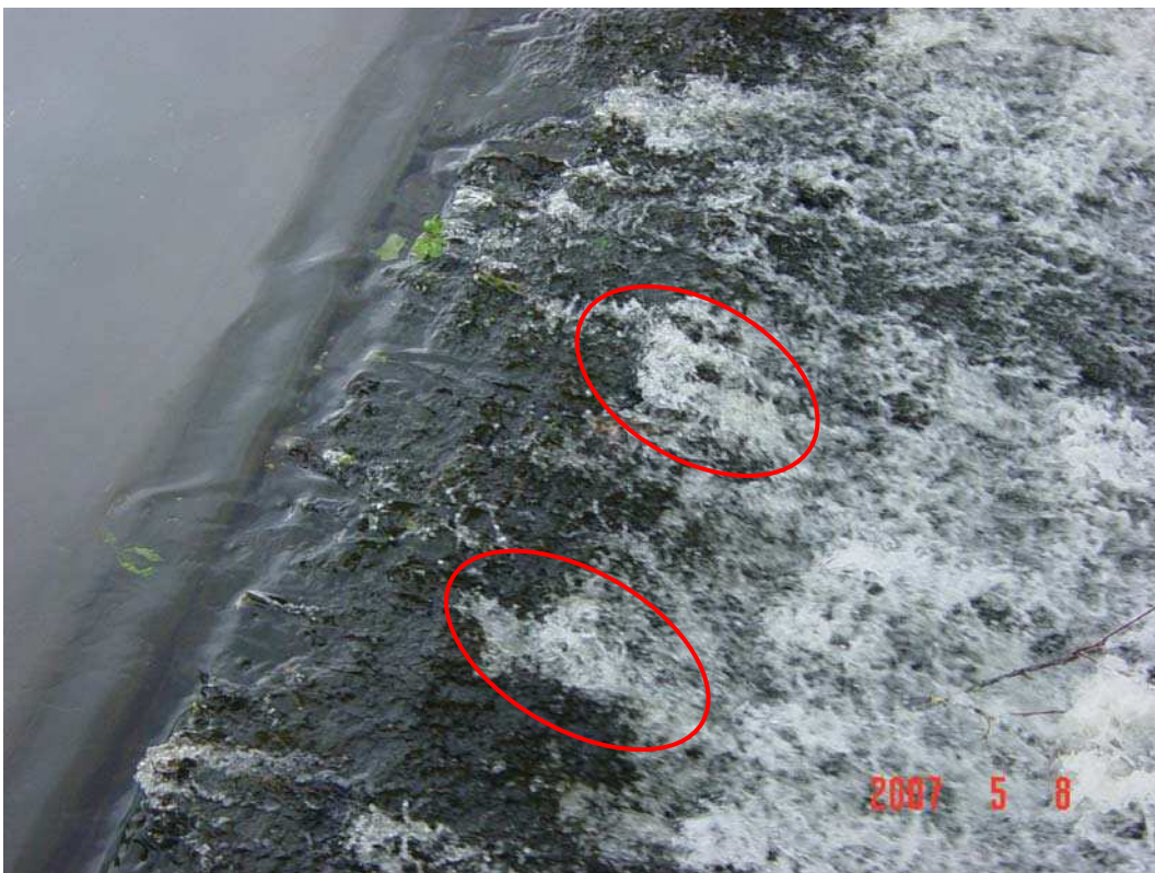
Abbildung 8: Ungleichmäßige Wasserablösungen auf der Wehrkrone
