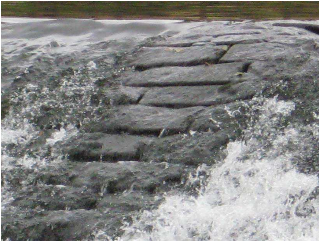
Abbildung 18: Freiliegendes Deckwerk im Hochpunkt der Wehrkrone
