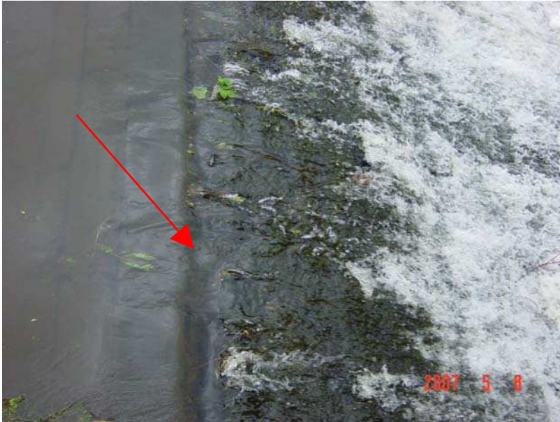
Bild 2: Deutliche Auswaschungen der Deckwerksfugen auf der Wehrkrone
