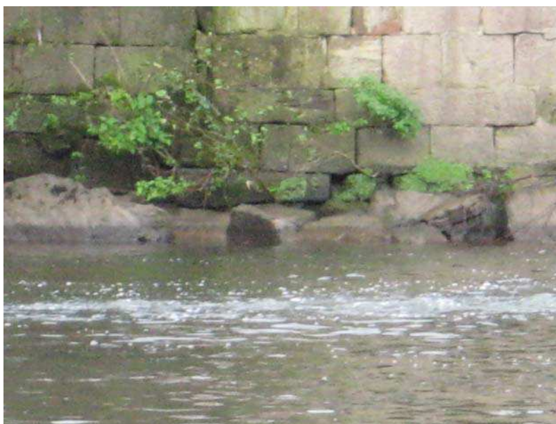
Bild 15: Wasserlinie Stützmauer rechts im Unterwasser
