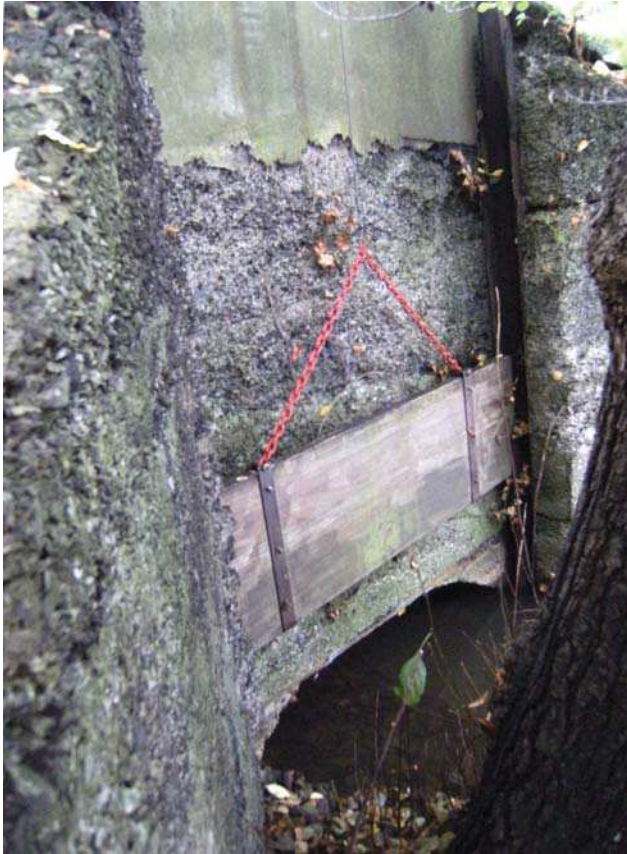
Abbildung 25: Schützenanlage am Einlaufbauwerk Hirsemühle
