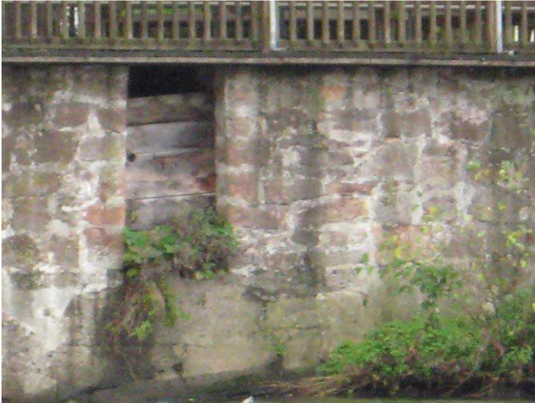
Abbildung 29: Verschlossene Öffnung in der Stützmauer rechts im Oberwasser
