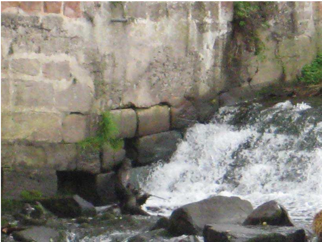
Abbildung 30: Beschädigtes Mauerwerk am Wehrfuß des rechten Lahnufers
