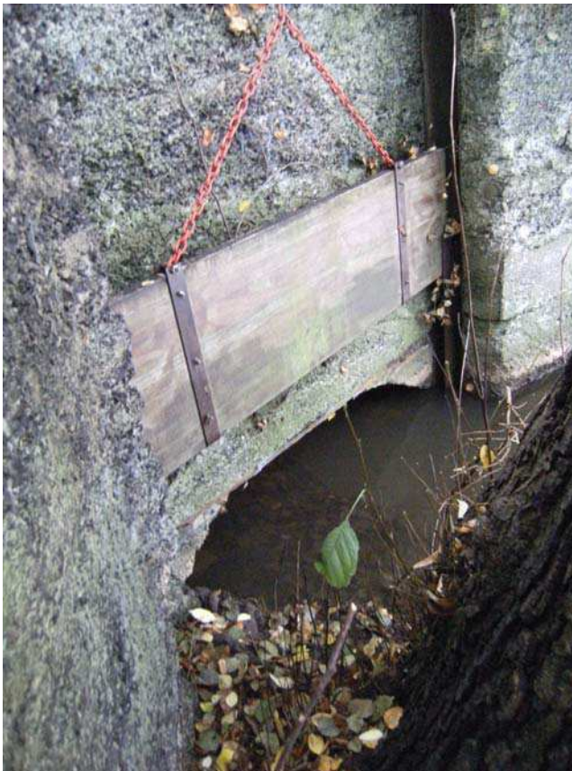
Abbildung 26: Schützenanlage am Einlaufbauwerk Hirsemühle
