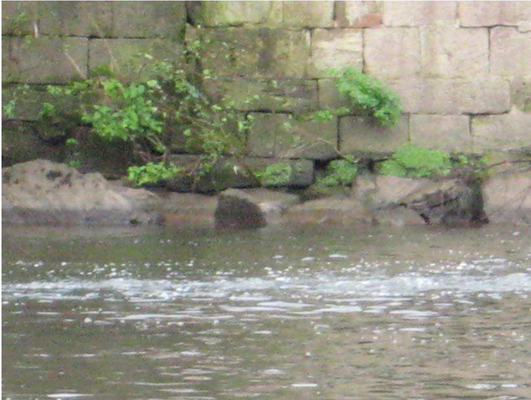
Abbildung 33: Wasserlinie Stützmauer rechts im Unterwasser
