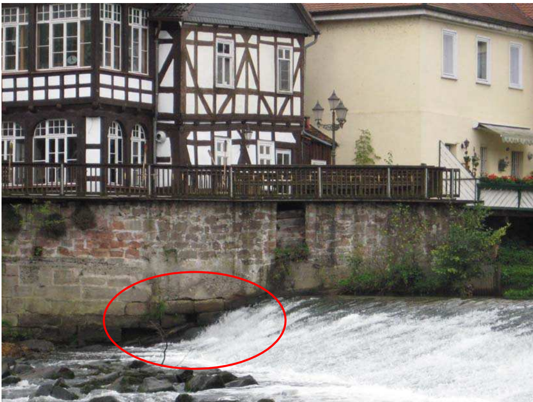
Abbildung 28: Schadensbild der Stützmauer an der Ölmühle am rechten Lahnufer
