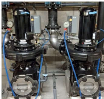
Weniger Energiekosten und CO 2 -Ausstoß mit den neuen Umwälzpumpen. (Foto: Stadt Marburg)
