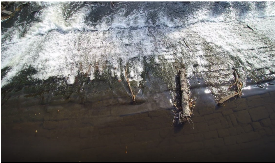
Abbildung 24: Offene Fugen im Deckwerk im Bereich der Wehrkrone, aus [14]
