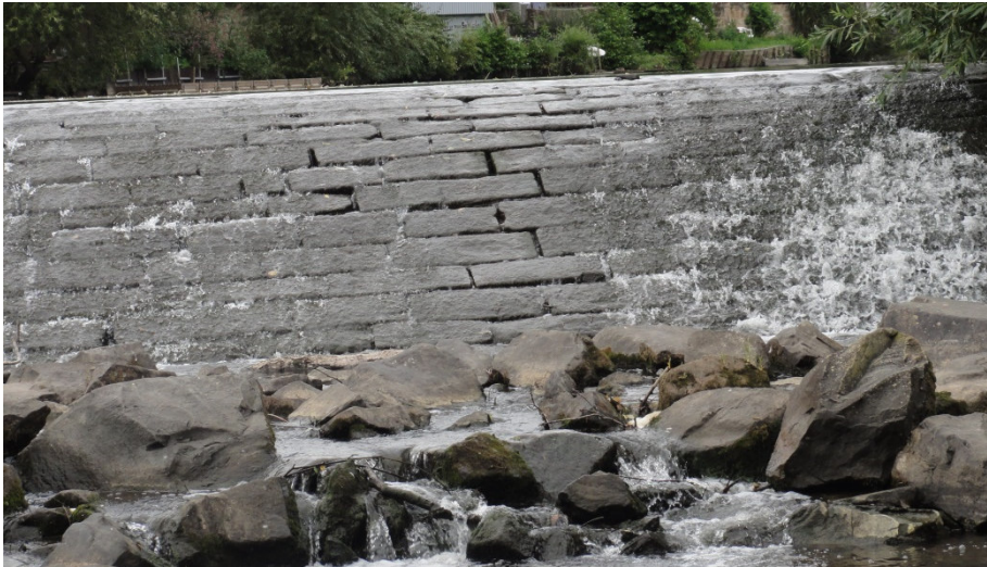
Abbildung 13: Offene Fugen im Deckwerk, linksseitig in Fließrichtung
