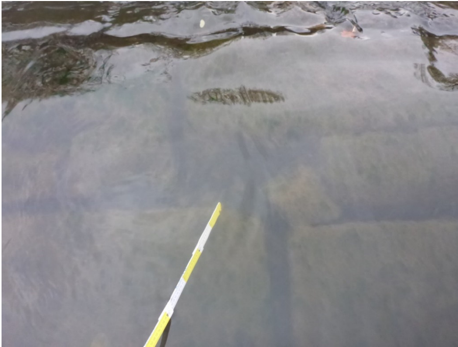
Abbildung 19: Wehrkrone, offene Fugen im Deckwerk
