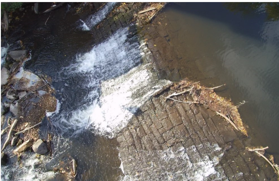
Abbildung 22: rechtes Wehrfeld, Setzungen des Deckwerks, aus [14]
