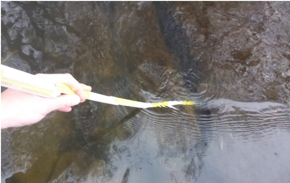
Abbildung 18: Wehrkrone, offene Fugen im Deckwerk
