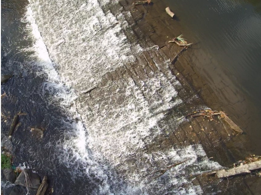
Abbildung 21: Mitte Wehranlage, Setzungen des Deckwerks im Oberwasser, aus [14]
