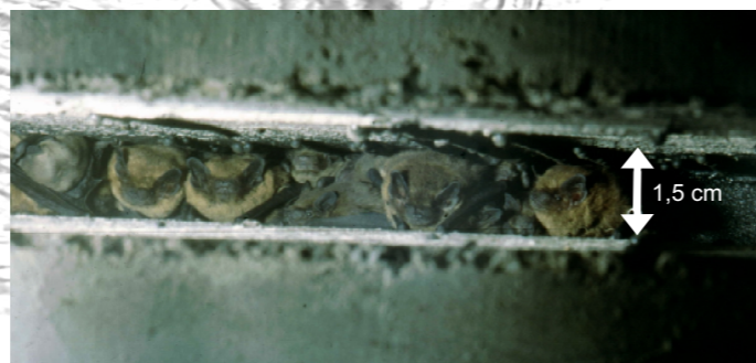
Wochenstubenkolonie der Zwergfledermaus in einer Betonspalte.
