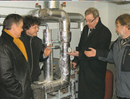
„Anfeuern“ Am Richtsberg: Neues Fernwärmenetz der Stadtwerke in den GeWo-Bau-Häusern in der Sudetenstraße (17.12.08)Foto: Brahms
