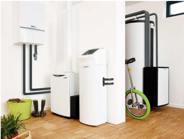
Abbildung 22: Das Mikro-BHKW als platzsparendes Kraftwerk (Quelle: http://www.freiepresse.de/DYNIMG/31/70/3843170_W700.jpg ).
