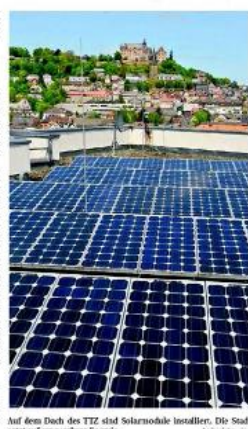
Auf dem Dach der TIZ sind Solarmodule installiert. Die Stadt hat auf Fotoarbeiten Energie.
