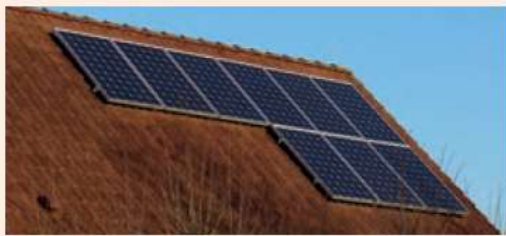
Anlage auf Schrägdach
