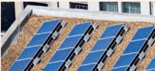
Anlage auf Flachdach
