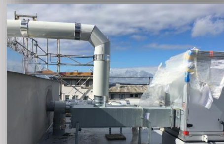
Fernwärme und Wärmepumpen
